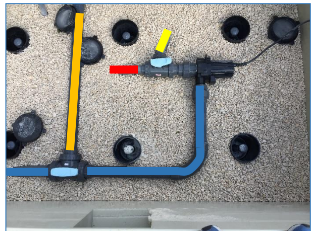
Saugleitung von den TECO Filter – Rückspüleleitung – Zirkulation Leitung – Ablauf Leitung
